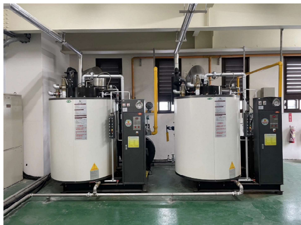
總廠鍋爐設備更新
