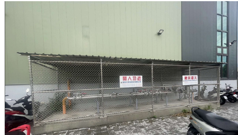
廠外天然氣管線閥
